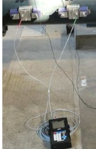
Fig. 1.2.9-56 L'installation est complète
