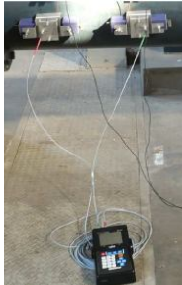
Fig. 1.2.9-41 L'installation est complète
