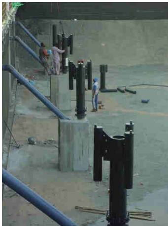
Installation en Arabie Saoudite
